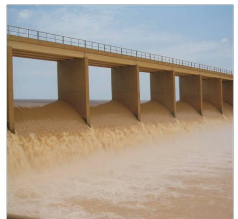
Déversement - Barrage de Ziga © Boureima Nebie
