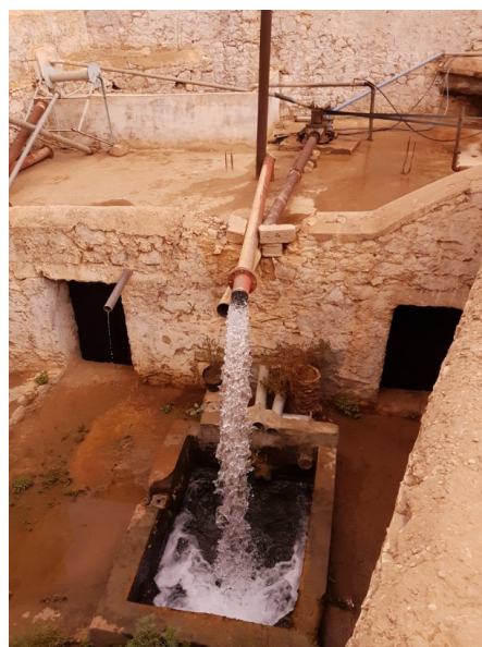
Station de pompage, Tiout © OIEau
